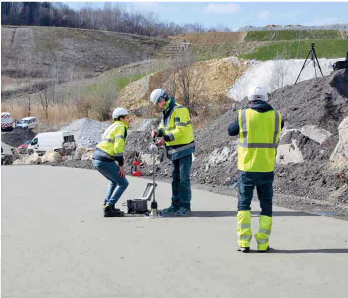
Die Einbaukontrolle erfolgte sowohl durch begleitende Frischbetonprüfungen als auch durch Verdichtungskontrolle mit zerstörungsfreier Messung der Raumdichte mittels Troxlersonde sowie mittels leichten Fallgewichtsdeflectometers.
