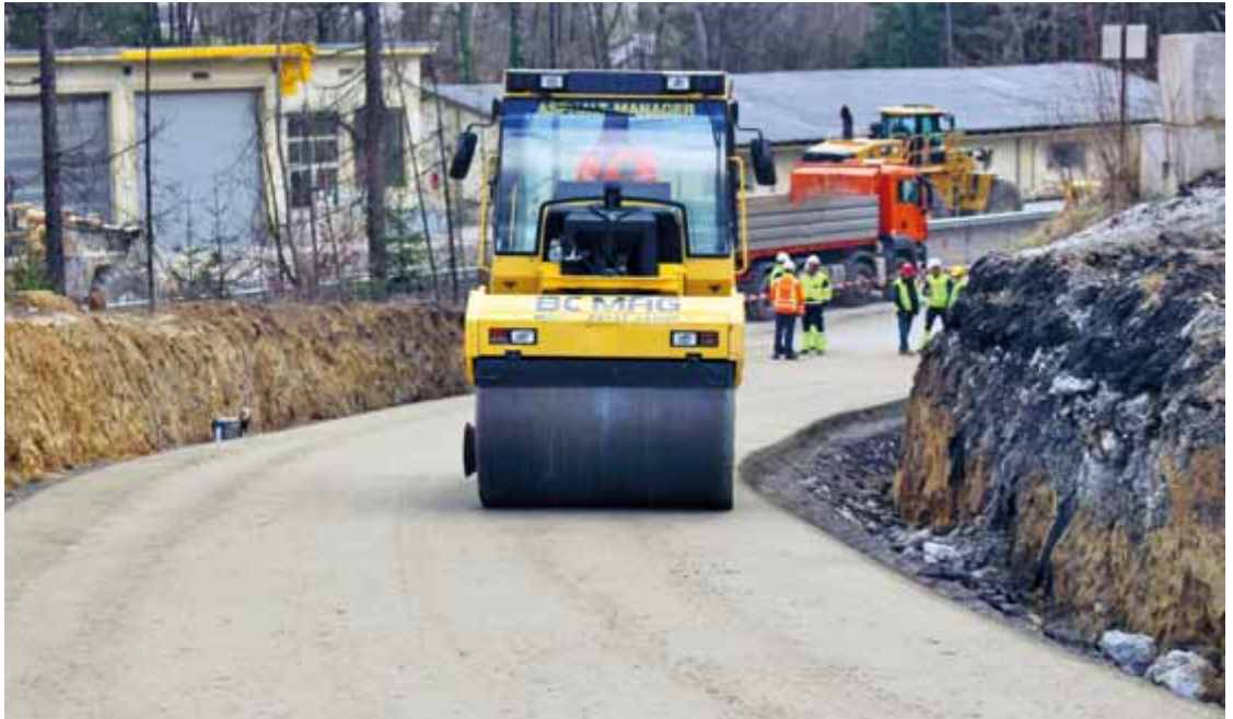
Der Walzbetoneinbau ist auch in Kurven und auf Strecken mit Steigung möglich.
