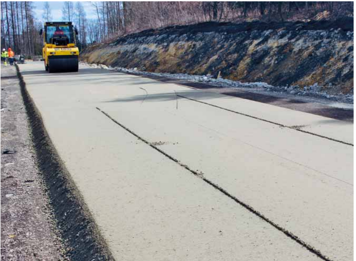
Nachverdichtung des Betons mit Glattmantelwalze: Die Stege im Vordergrund werden durch die Nachverdichtung noch geglättet.
