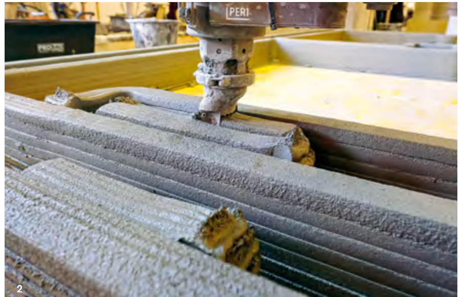
1 + 2 Die Wände des Einfamilienhauses in Beckum wurden dreischalig gedruckt: Der Druckkopf fährt dabei ständig hin und her und schichtet die gepressten Betonschlangen präzise aufeinander; der entstandene Luftraum wird mit Dämmmaterial aufgefüllt. Aussparungen und Schlitze für später ausgeführte Leitungen und Anschlüsse werden während des Druckvorgangs mitberücksichtigt.
