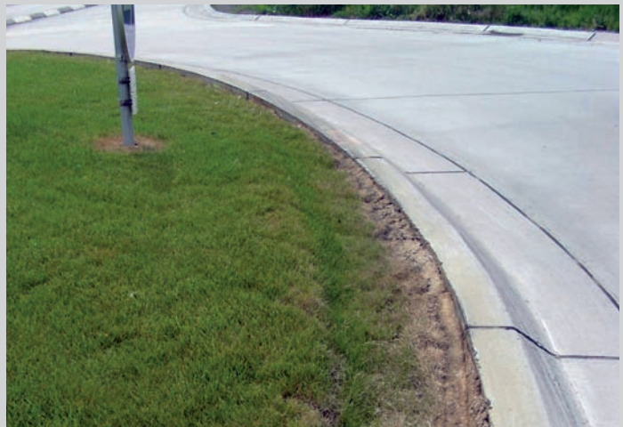
Intakte Bord-/Rinnenanlage und Schädigung der Kreisinsel Foto: Autor
